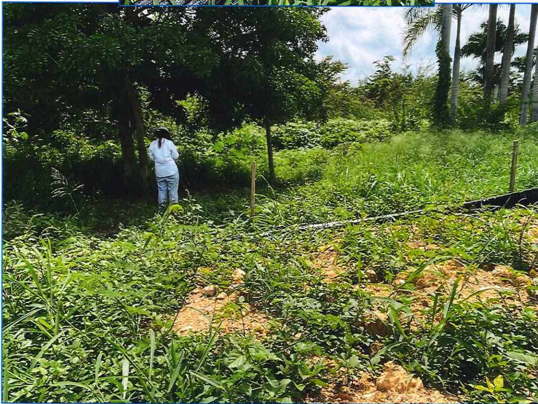
Imagen 8. Deficiencia en el Plan para el Control de la Erosión y Prevención de la Sedimentación.
